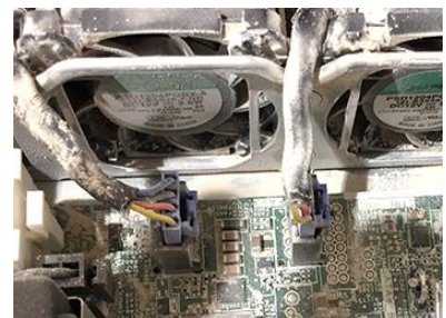
Baustaub in Lüftern
